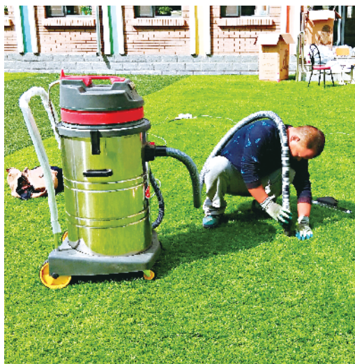
橡胶颗粒 工人正在加紧施工,清理草坪中的橡胶颗粒 摄影/本报记者 张巧珍
