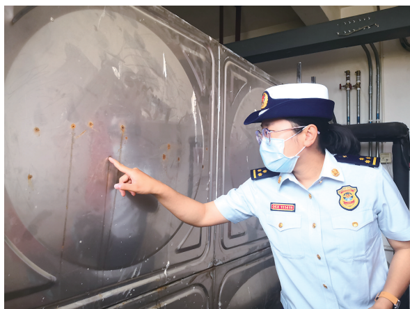
消防监督员检查发现该小区高位水箱沙眼较多,无法正常使用。
