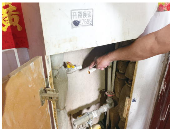
被切断的自来水管
