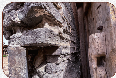
墙体出现空心
