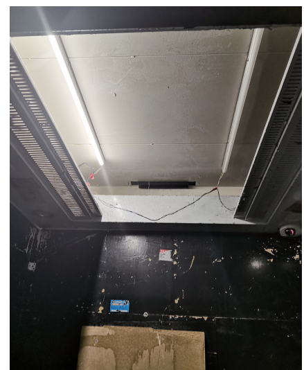
电梯照明设备和电线裸露在外
