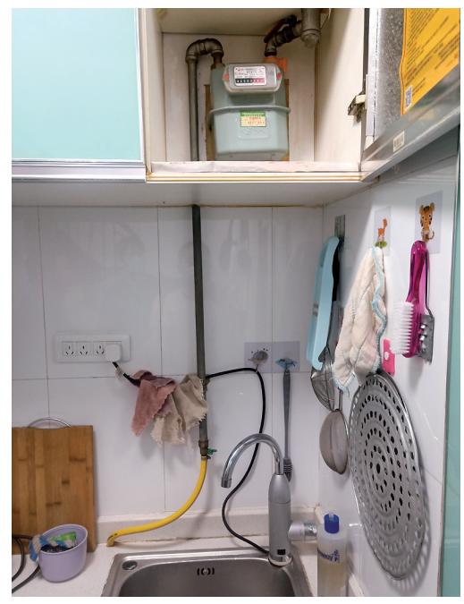
泉盛小区底商使用天然气做饭
