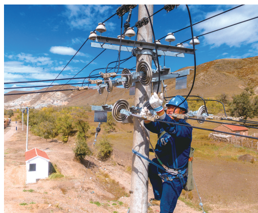
国网蒙东电力员工在赤峰市克什克腾旗永盛五台地区进行线路升级改造。陈梓 摄
