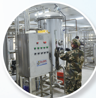
阿右旗骆驼产业科技园一期6000吨驼奶深加工生产线。
