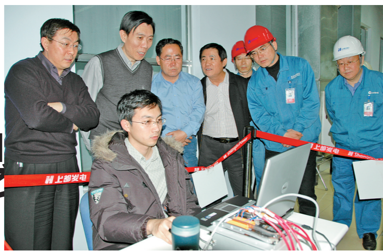
上都电厂附加励磁阻尼控制、轴系扭振保护装置试验现场。
