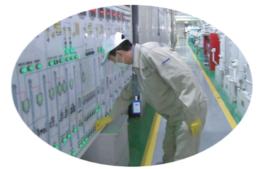
技术人员在检查设备运行情况。
