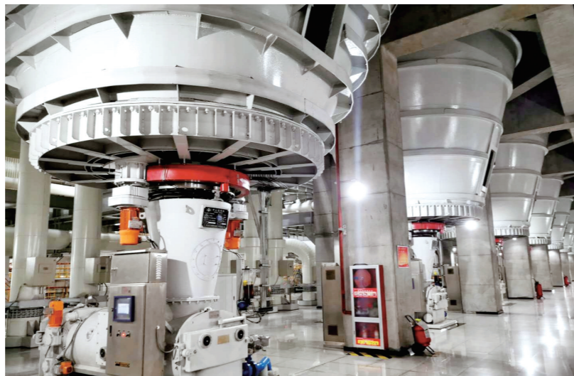
延期提水核心装置。
