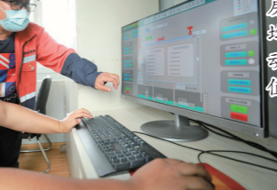
排水泵所有阀门更换为电动阀门无人值守系统。
