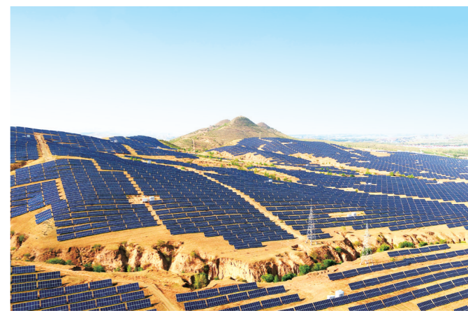
光伏发电板满山坡。
