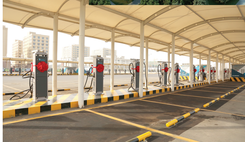
呼和浩特市新能源电动汽车综合复用充电站。
