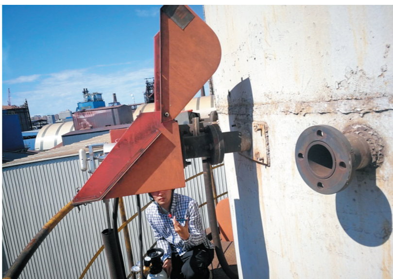
比对监测孔未按规定封闭
