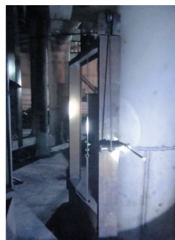
碳化工段废气通脱硫塔的旁路开关。
