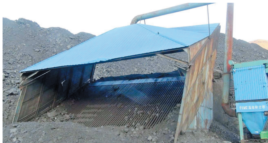
敞开式上料口及筒仓除尘器(未运行)。
