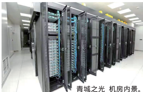
青城之光 机房内景。
