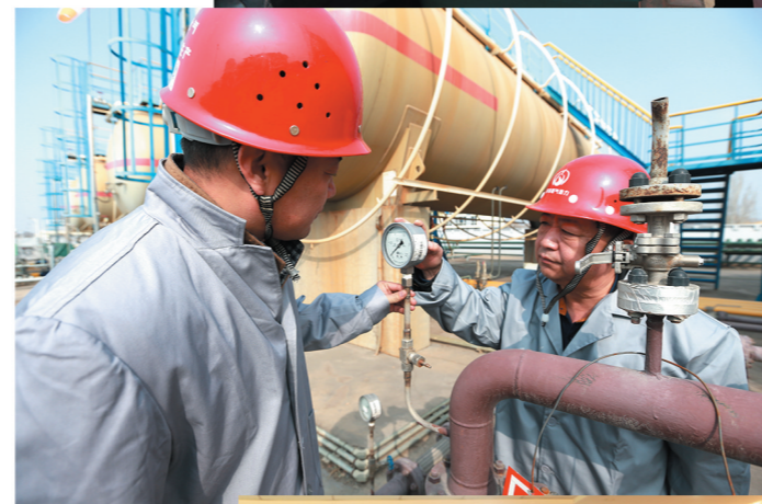
3·15前夕,自治区市场监管局特种设备安全监察局工作人员走进呼和浩特市城市燃气热力有限公司对设备进行安全检查。田伟 摄
