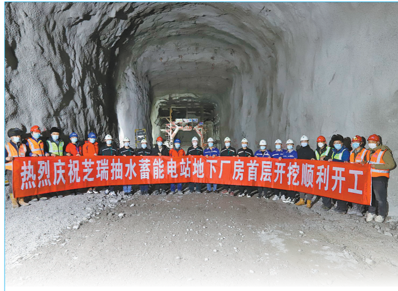
热烈庆祝芝瑞抽水蓄能电站地下厂房首层开挖顺利开工
