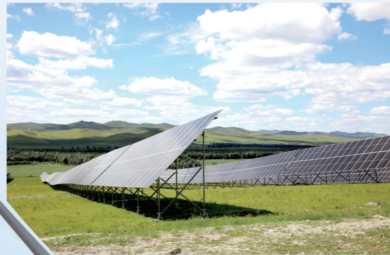
天合科右中旗150MWp光伏储能综合治沙项目现场,一排排太阳能电池板整齐排列。 图雅 摄
