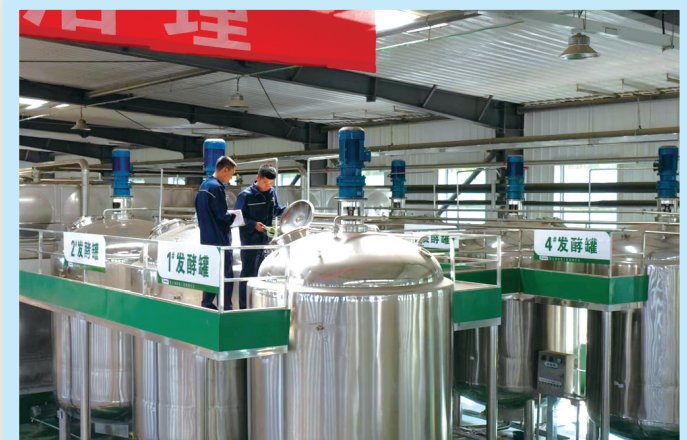
病死畜禽无害化处理厂处理设备。
