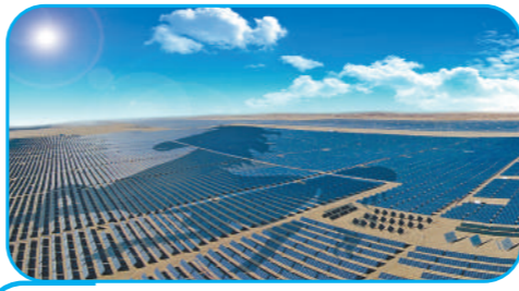
达拉特光伏发电应用领跑基地。
