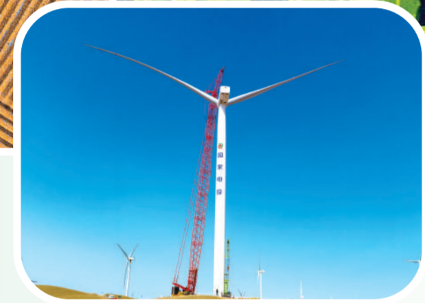
霍林河循环经济示范工程30万千瓦风电项目施工现场。 刘克强 摄
