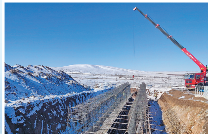
在中国二冶集团路桥分公司白固公路项目建设现场,工人正在绑扎钢筋。 本报记者 孟和朝鲁 摄
