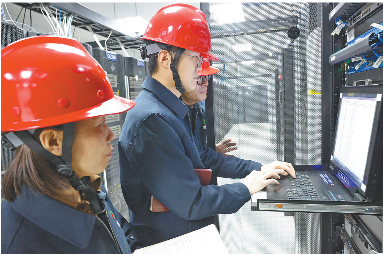
“铁-铬液流”储能项目工作人员在对储能接入系统进行拓扑调试。
