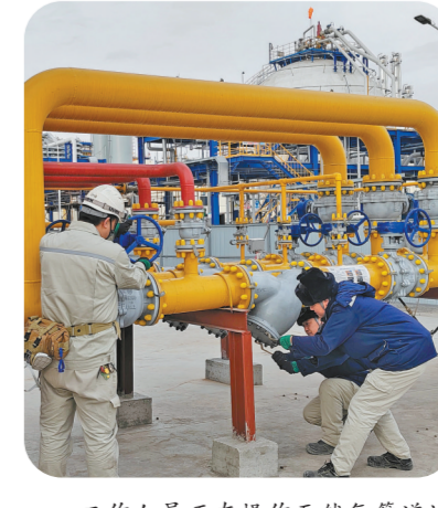
工作人员正在操作天然气管道过滤器滤网。
