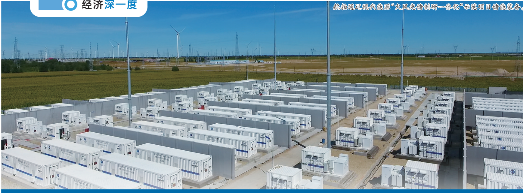
抗拍通现代能源“风光氢储制研一体化”示范项目储能装备。
