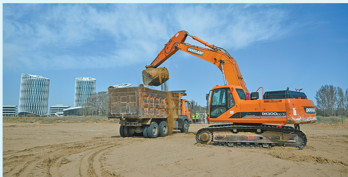
显鸿集成电路产业园项目开工奠基仪式现场。本报记者 王磊 摄
