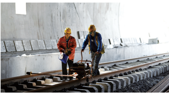
工作人员正在检查线路设备。 纪恩泉 摄
