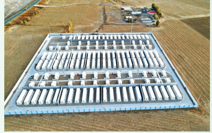
开鲁县内蒙古光明新能源“风、光、储、制、研”一体化示范项目345兆瓦时
