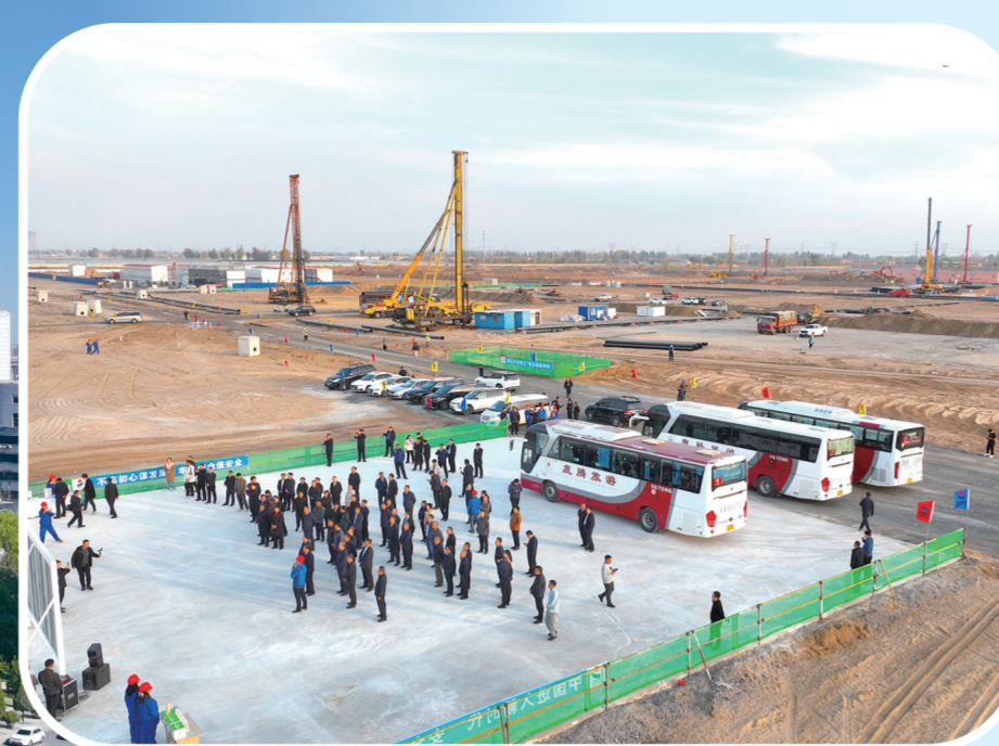
包头中车电机有限公司稀土永磁风力发电机建设项目现场。
