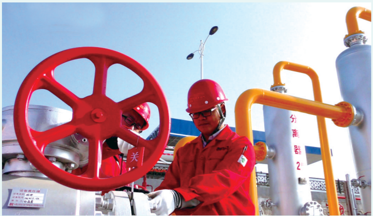
输气工在工艺区进行阀门维护保养。
