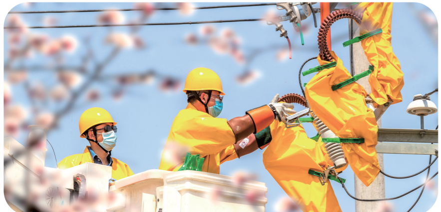
国网奈曼旗供电公司员工对10千伏工业园区线进行带电消缺。张东雷 摄
