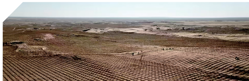
锡林郭勒防沙治沙和风电光伏一体化项目沙障铺设现场。
