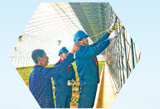
巴彦淖尔市临河区区域镇蔬菜种植大棚中,供电公司工作人员为农户用电设备排除安全隐患。 王馨伟 摄
