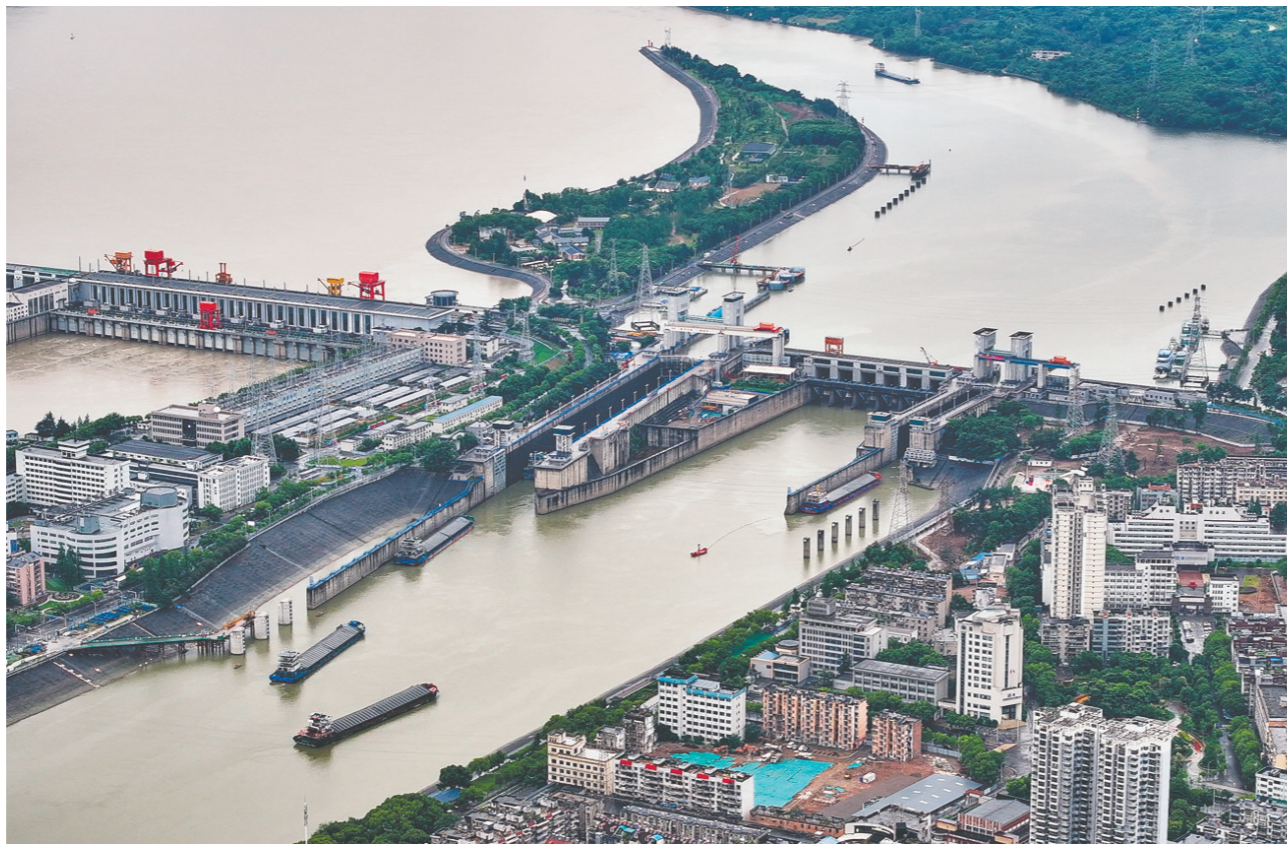
6月8日拍摄的三峡水运新通道工程葛洲坝航运扩能施工现场。
