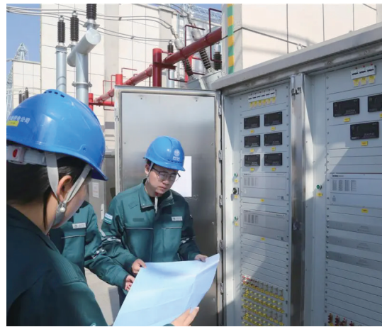
4月6日,赤峰连场500千伏变电站作业人员王雨桐对主变压器二次设备进行春检。
