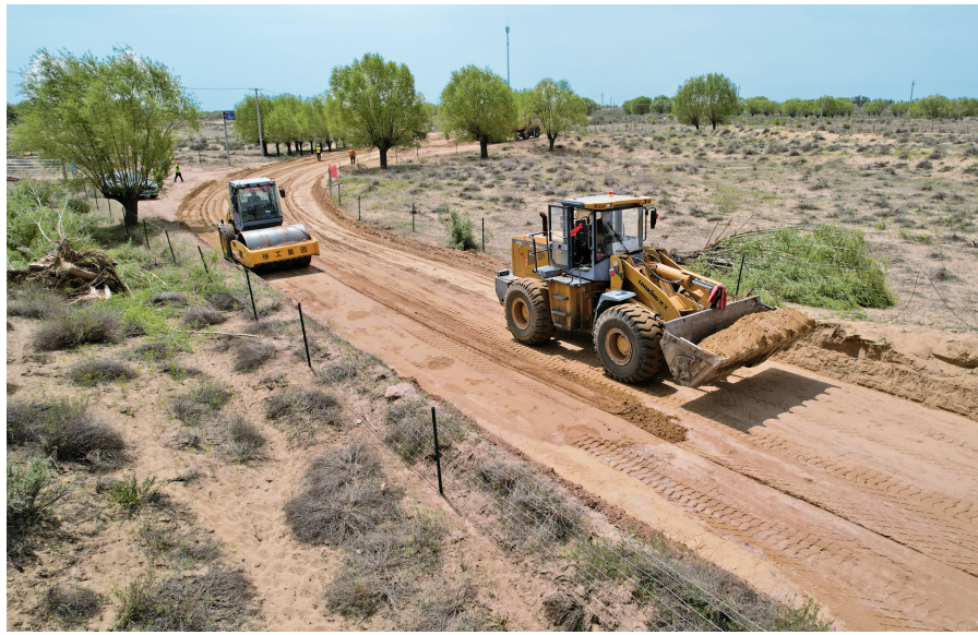
正在施工的乌审旗S215线至呼和芒哈一号气站通社公路
