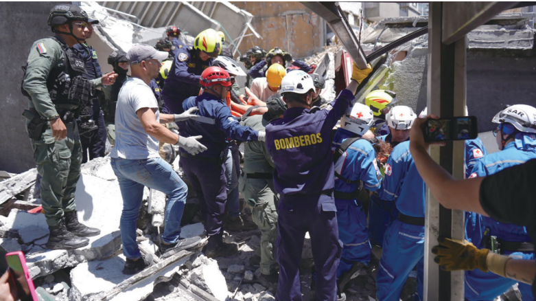
在哥伦比亚城市马尼萨莱斯,救援人员在遭受地震破坏的建筑物废墟上开展救援。
