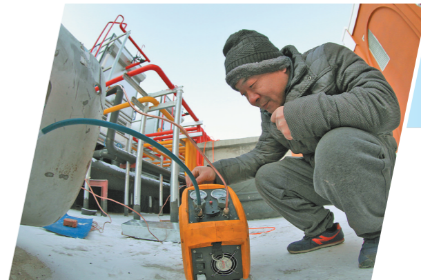
制冷机储备罐压力检测。
