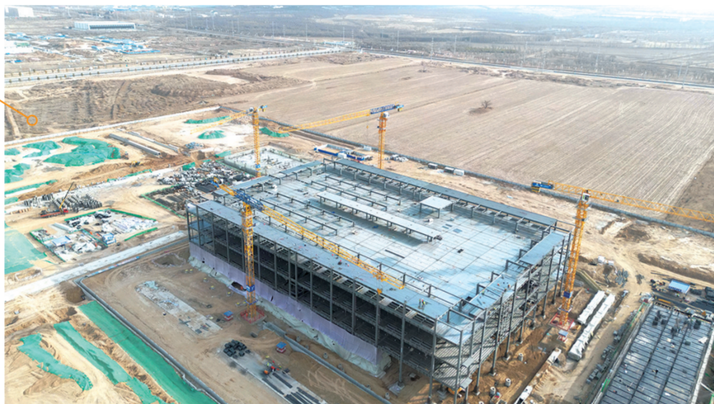
呼和浩特——华为云和林格尔数据中心项目。
