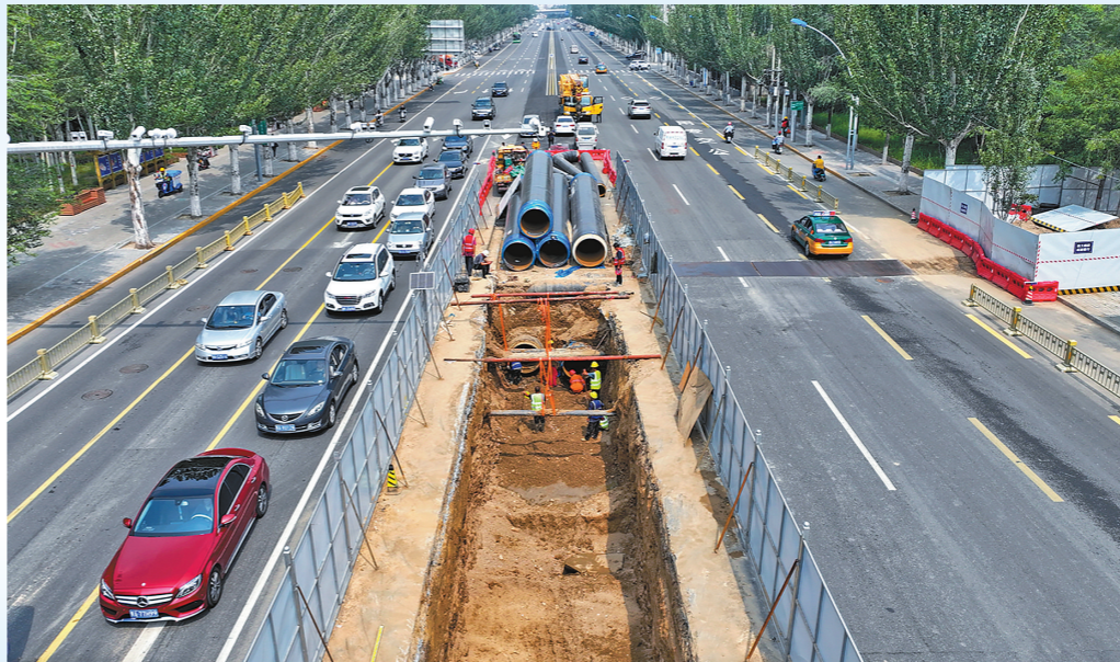
呼和浩特市呼伦路“温暖工程”一次管网施工现场。 通讯员 李邵诚 摄
