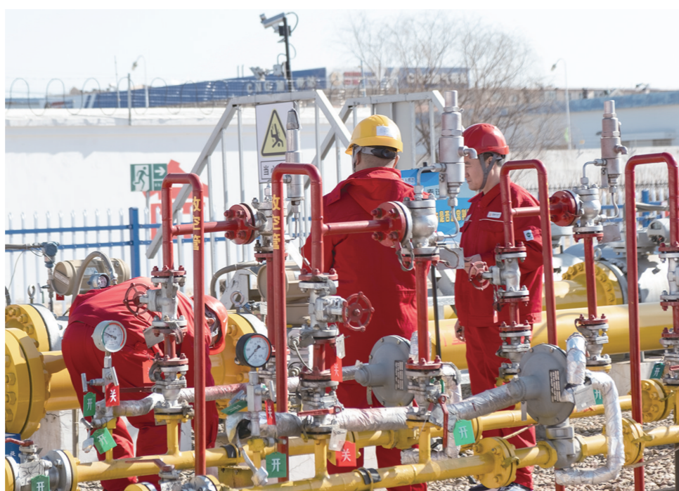
场站设备维护保养。
