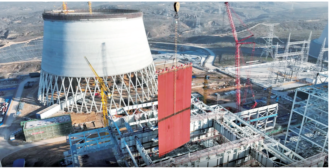
重点工程建设加快推进 11月25日,在内蒙古汇能川龙发电有限公司2×660兆瓦扩建项目建设现场,一件长20米、宽11米、总重37吨的2号锅炉垂直水冷壁组件正在进行吊装。鄂尔多斯市准格尔旗今年共有区、市两级重点项目66个,截至目前,全部项目加快推进,已完成投资241.11亿元,占年度计划的82.9%。 本报记者 毛错彦 摄
