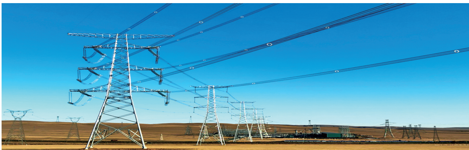
内蒙古第8条特高压工程——张北至胜利1000千伏特高压交流工程投运。国网蒙东电力精益运维特高压,确保外送通道安全稳定。摄影 马超
