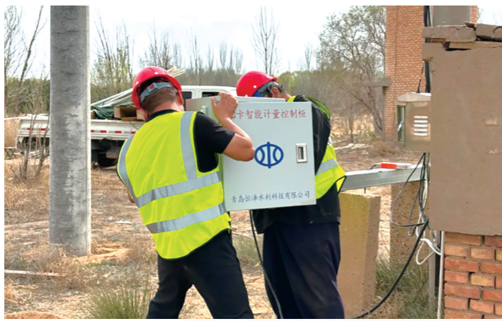
安装“井电双控”计量设备。
