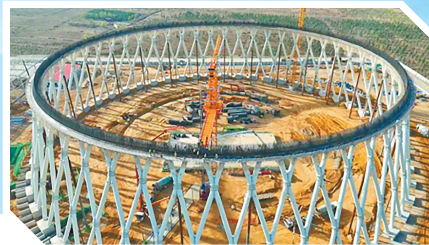
工商银行内蒙古分行提供贷款支持的内蒙古能源集团金山发电厂2×66万千瓦煤电扩建项目。
