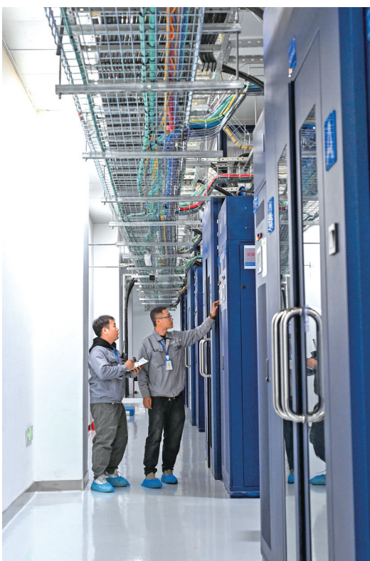
工作人员巡检算力设备。
