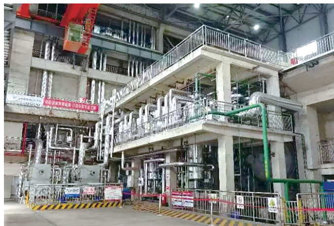
内蒙古亚新隆顺特钢有限公司煤气发电节能综合利用项目。
