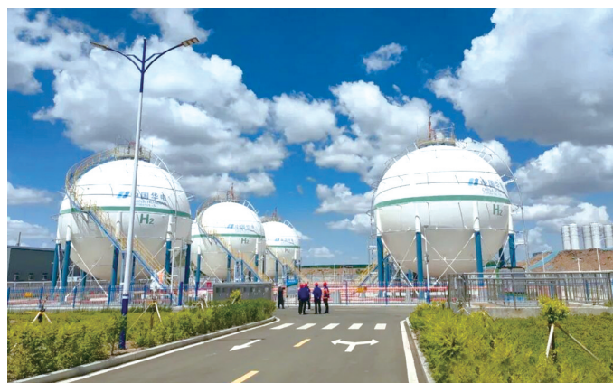
内蒙古华电氢能科技有限公司储氢罐区。
